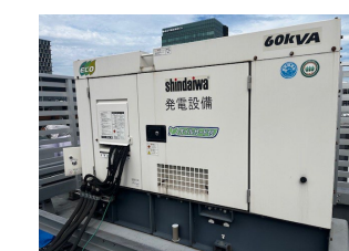
対象の非常用発電機
