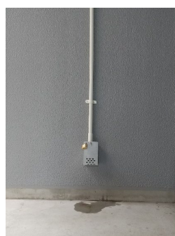
浸水センサーの設置
